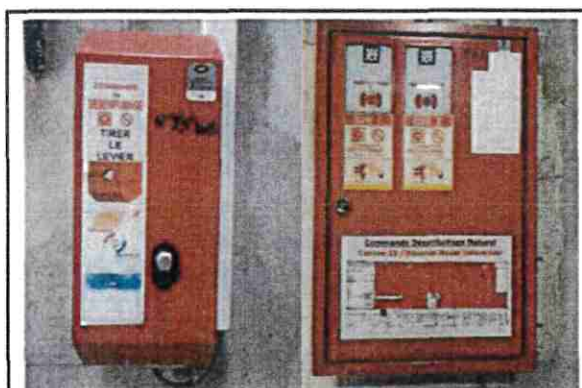
Commande de désenfumage escalier protégé
